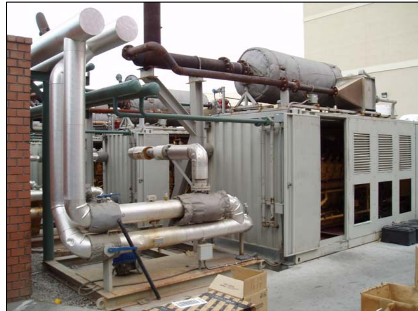
820 kW Ipanema Generator Rio All-Suites Hotel & Casino, Las Vegas
