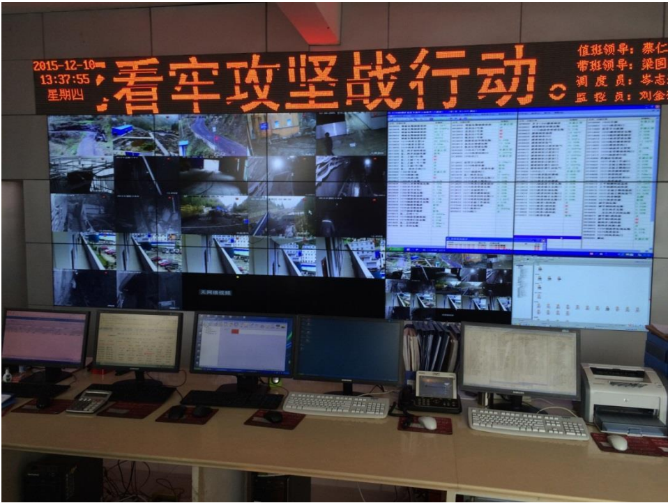
图 2-3 六龙煤矿监控室
