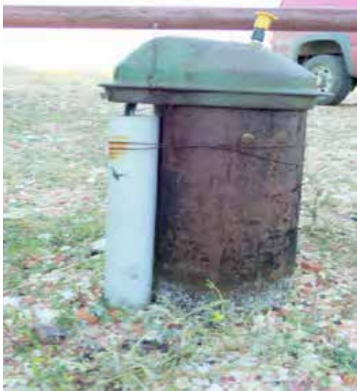
Conduit not sealed
