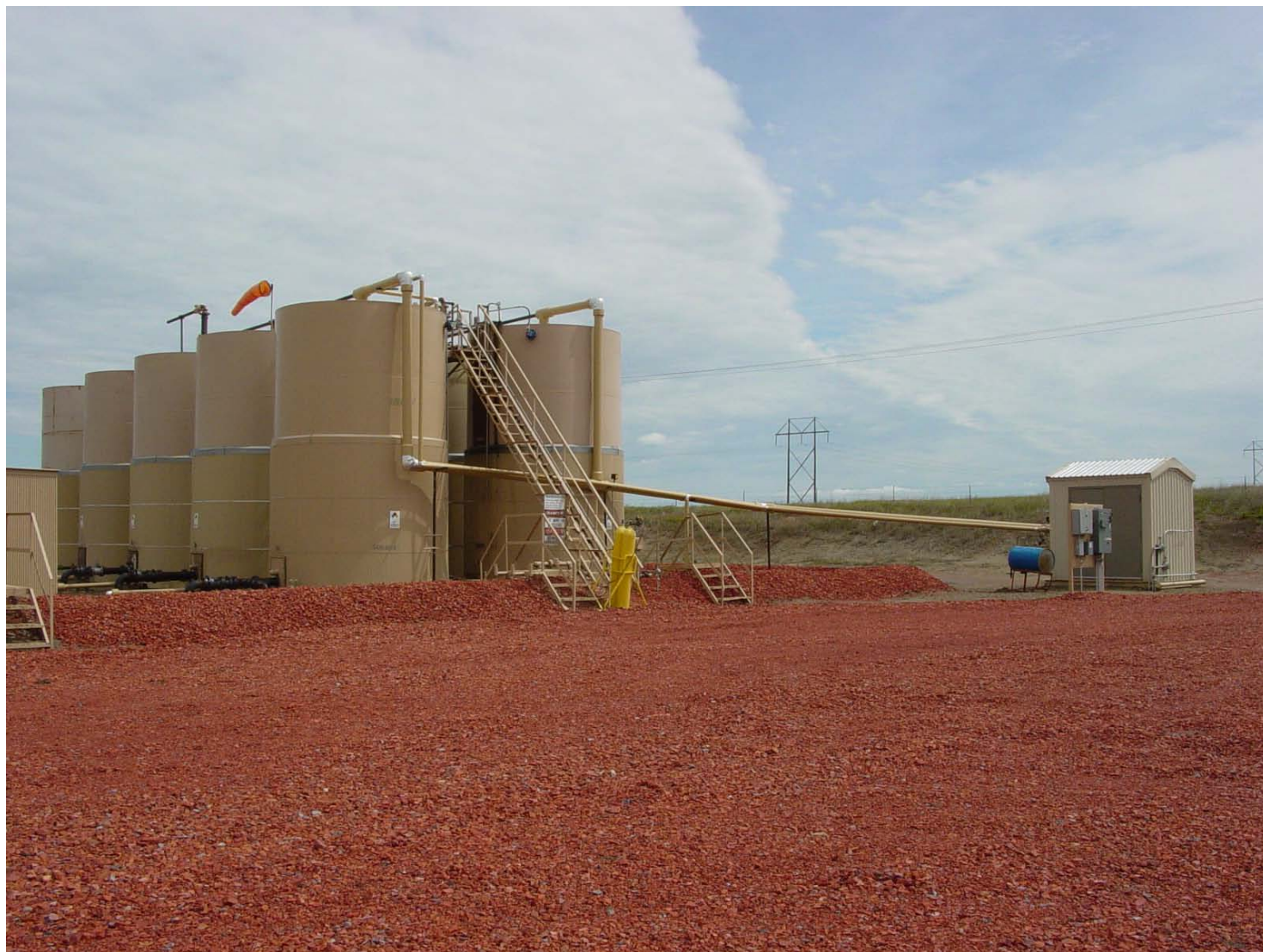
Установка улавливания паров компании ConocoPhillips на месторождении Бейкер (Baker) в штате Монтана; фотография предоставлена компанией Hy-bon Engineering
