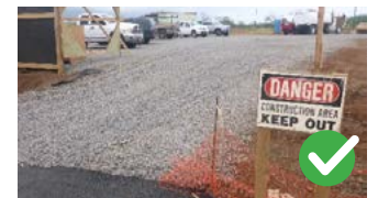
Buen mantenimiento de la plataforma de grava en la entrada de construcción
