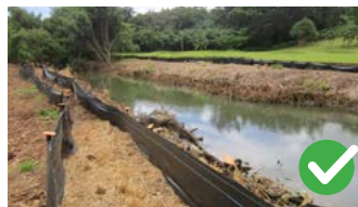
Instalación y mantenimiento adecuados de la valla barrera a lo largo de la vía fluvial
