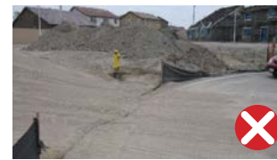
Los vehículos rastrean sedimentos a la carretera
