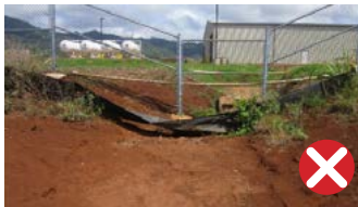
Valla Barrera colapsada instalada en áreas de flujo concentrado
