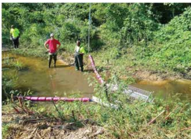
Instalación de un Litter Gitter, o trampa de basura, instalada a lo largo de un arroyo en los EE. UU.
