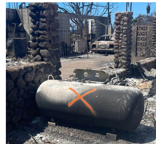
橙色油漆 = 化粪池系統位置、損 壞的變壓器或現場遺留的高危物 品
