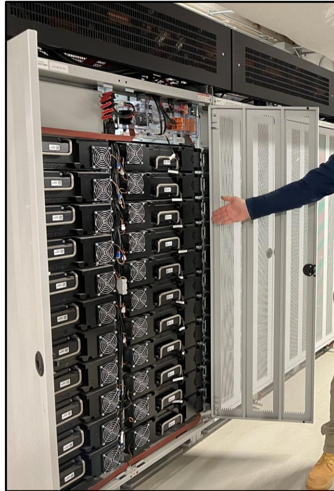
Rack de baterías (22 módulos)
