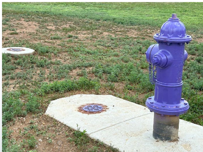
Effluent hydrant valve.
